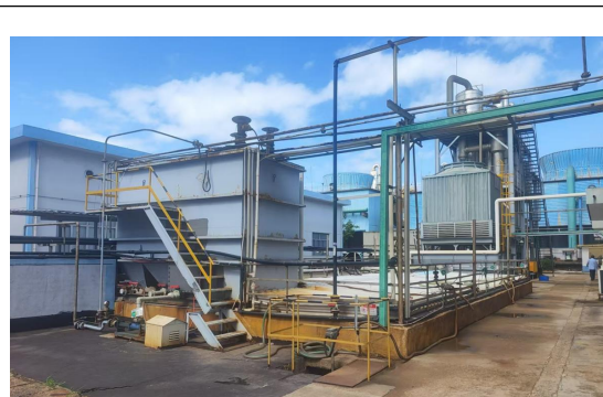
污水处理站照片
